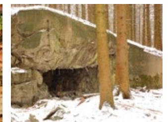
43. Absturzhöhe an einer Bunkerruine. Unachtsame Wanderer, die von der anderen Seite auf die ehemalige Decke gelangen, könnten die Absturzkante übersehen und sich verletzen. Foto: BUND RLP
