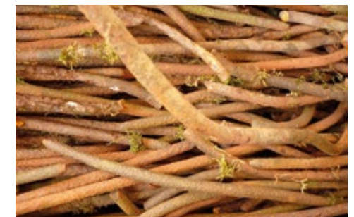
17. Entfernte Moniereisen. Bei Entfernung aller Moniereisen an einer Ruine kann der Preis mehrere 1000 € betragen. Meist genügt die Entfernung einzelner gefährlicher Eisen für wenige 100 €. Durchführung: MARKUS THIES. Foto: BUND RLP
