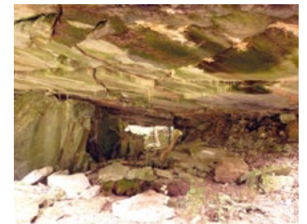
47. Abplatzende Betonplatten eines Aufbetons. Foto: BUND RLP
