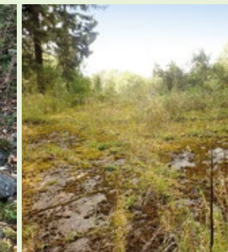
63. Deckenplatte einer Bunkerruine, die als Aufwärmplatz für Reptilien und Säuger nicht übererdet wurde. Foto: BUND RLP
