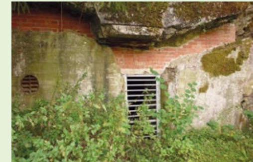
66. An der Ruine hat man zum Schutz vor Störungen „Fledermaustüren“ eingebaut. Die großen Spalten in der Außenwand wurden mit Ziegeln vermauert, um das Innenklima zu verbessern und überwinternde Tiere vor Frost zu schützen. Für Säugetiere wie die Wildkatze wurden Öffnungen gelassen. Durchführung: MARKUS THIES. Foto: BUND RLP
