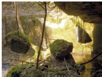
44. Herabhängende Betonbrocken und Moniereisen an einer Bunkerruine. Foto: BUND RLP
