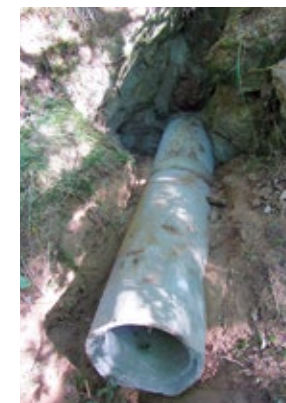
67. Beim Verschluss von Einspülungsspalten (hier am Wanderweg in Dasburg) werden Betonröhren eingesetzt. Um einen für Tiere nutzbaren Winkel zu erhalten, muss teilweise Erdrich abgetragen werden. Andernfalls kann die gutgemeinte Maßnahme zur Todesfalle für Kleinsäuger und andere werden. Der Preis für solche Röhren liegt je nach Aufwand im Bereich weniger 100 €. Durchführung und Foto: MARKUS THIES
