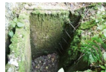
41. Ehemaliger Notausgang mit Absturztiefe von ca. 2,5 m. Hier besteht dringender Handlungsbedarf, da die Gefahr der von schlecht sichtbaren Einspülungsspalten gleicht! Foto: BUND RLP
